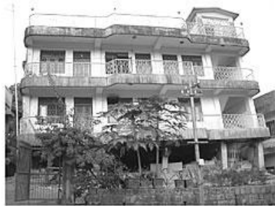
FALLAS POR PRIMER PISO ABIERTO
