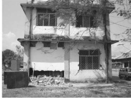
Edificación nueva de concreto reforzado, dañada
